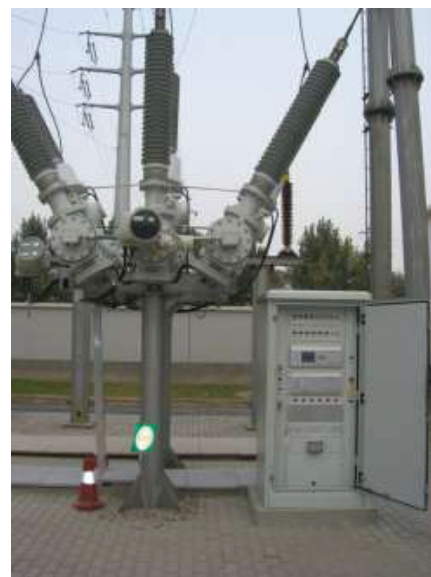
Рис. 7. Шкаф с интеллектуальным терминалом на подстанции Jin guiyuan (Китай)
