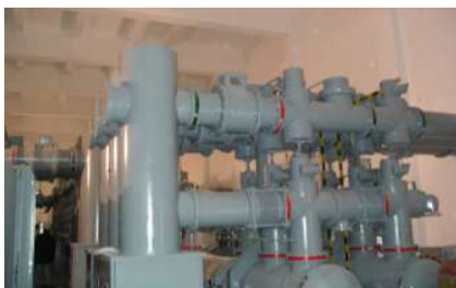
Рис. 5. GIS-электронные ТТ/ТН на подстанции Wushan (Китай)
